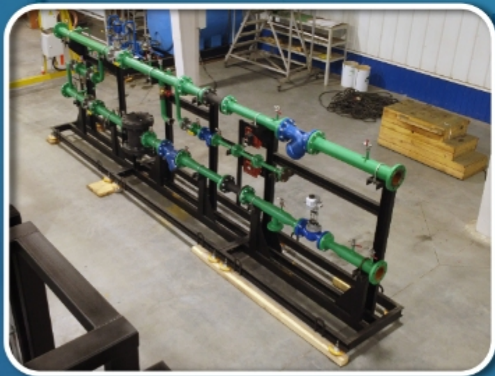
Модуль ввода теплоносителя
